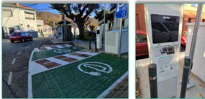
Figura – Estaciones de recarga instaladas en la comarca de Sierra de Gata.
