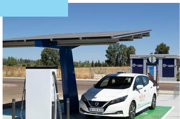
Imagen 30. Punto de recarga alimentado con instalación F.V. sobre marquesina. IFEBA. Ayuntamiento de Badajoz.
