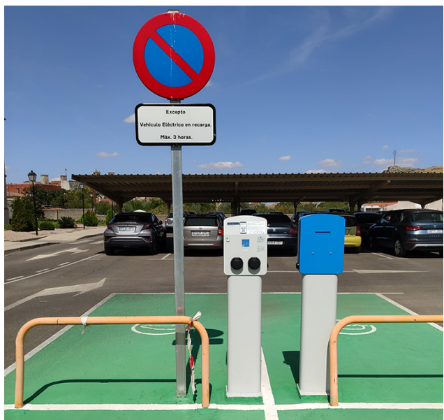
Imagen 21. Estación de recarga en destino de 22 kW en el aparcamiento del Complejo San Francisco perteneciente a la Excm. Diputación Provincial de Cáceres.
